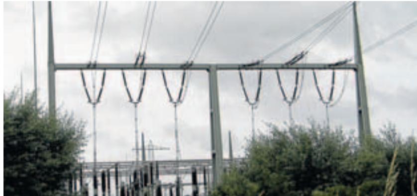
Das Wahler Umspannwerk soll Ausgangspunkt sein für die umstrittene Höchstspannungsleitung nach Mecklar. Foto: Grohmann/Archiv
