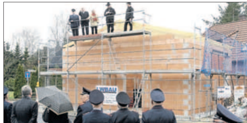
Beim Richtfest (auf dem Gerüst von links): Alfred Becker (stellvertretender Ortsbrandmeister), Bürgermeister Hartmut Marotz, Ortsvorsteherin Marieluise Dambroth, die Zimmermänner Bernd Tolksdorf und Jens di Fulvio. Foto: Bode
